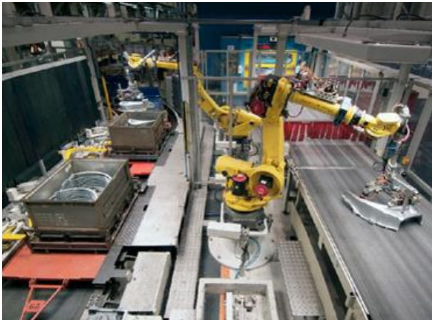
Figura 23. Descarga automática de la prensa GT2 [20]
