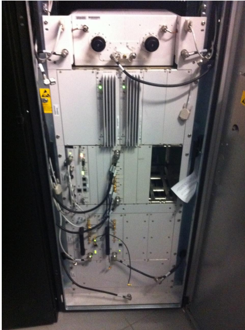
Figura 4.27: Ejemplo de un armario de una Estación Base.
