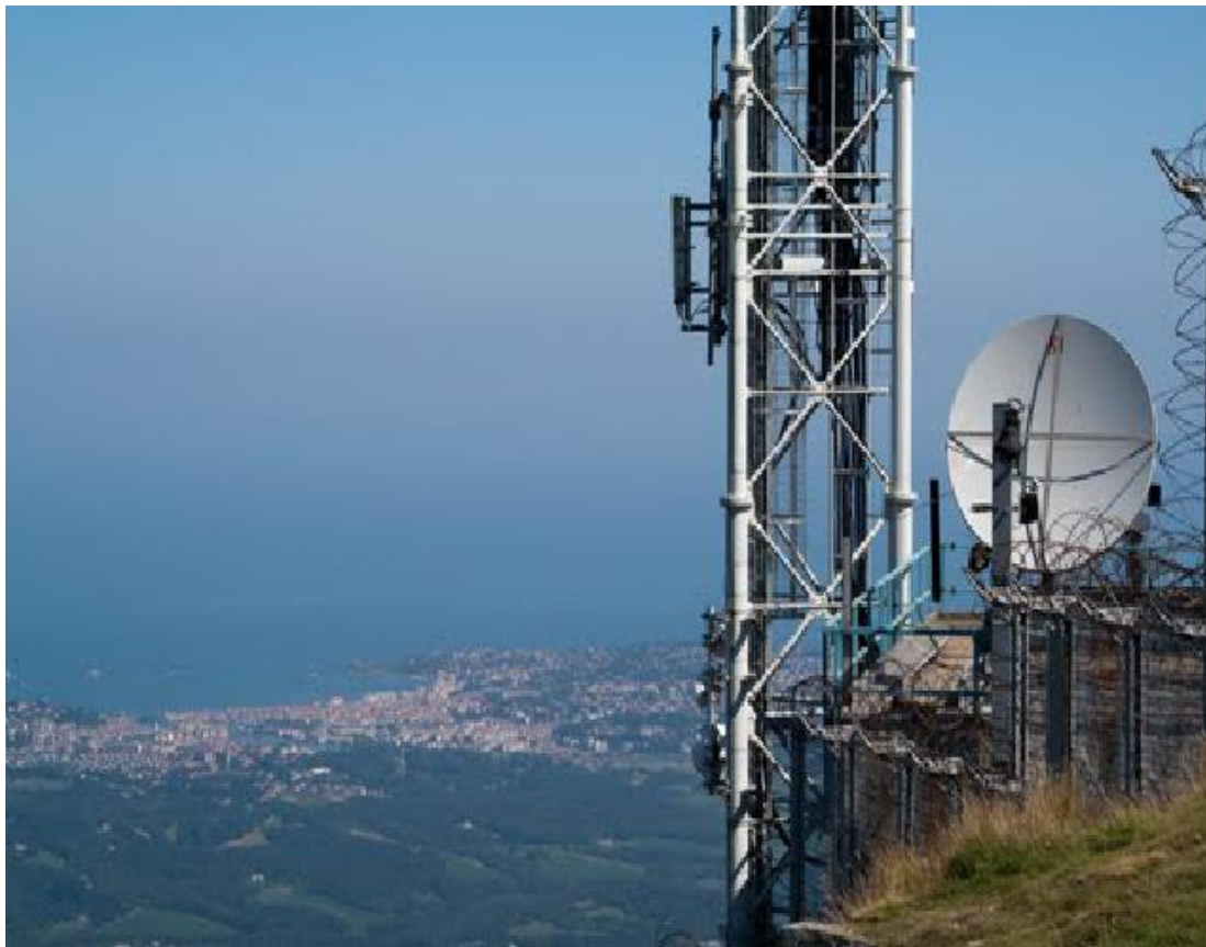
Figura 4.12: Torre de Telecomunicaciones donde se instalaran las futuras antenas de la nueva Estación Base de Larún. [16]
