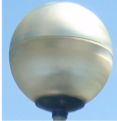
Figura 4.8: Luminaria tipo globo instalada en la UPNA
