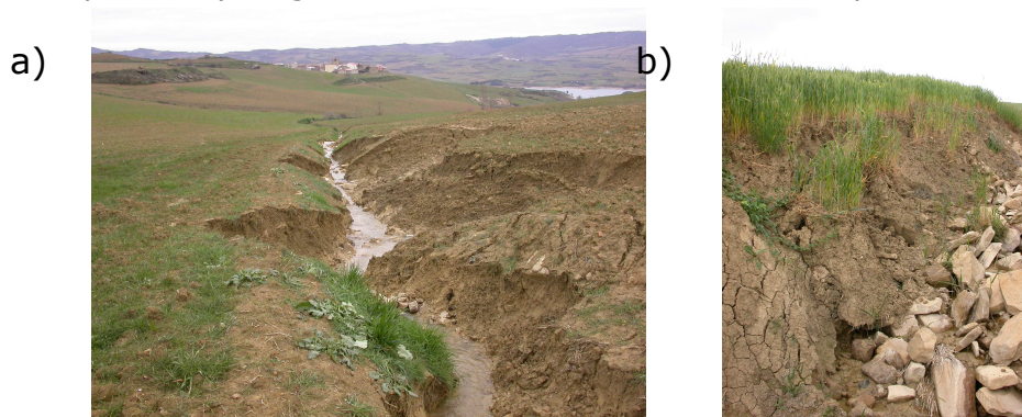
Figura 2.23.a) derrumbe y erosión de taludes de cauce, empujados por el propio deslizamiento, b) inestabilidad de taludes, cauce relleno con rocas, ambos en la cuenca de La Tejería .
