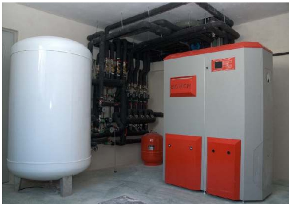
Imagen 14 Caldera y acumulador de Aoiz
