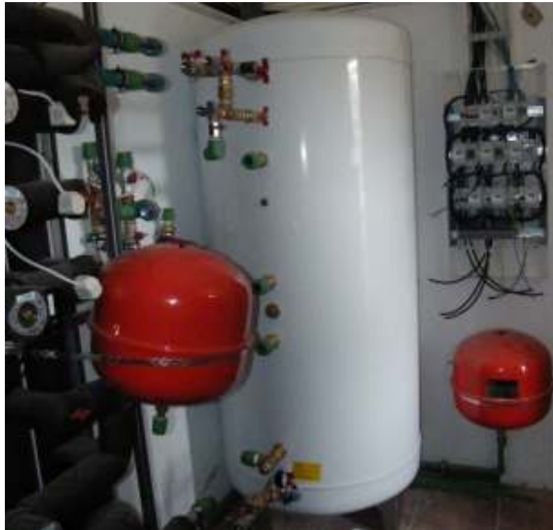
Imagen 11 Sala de calderas Gazcue
