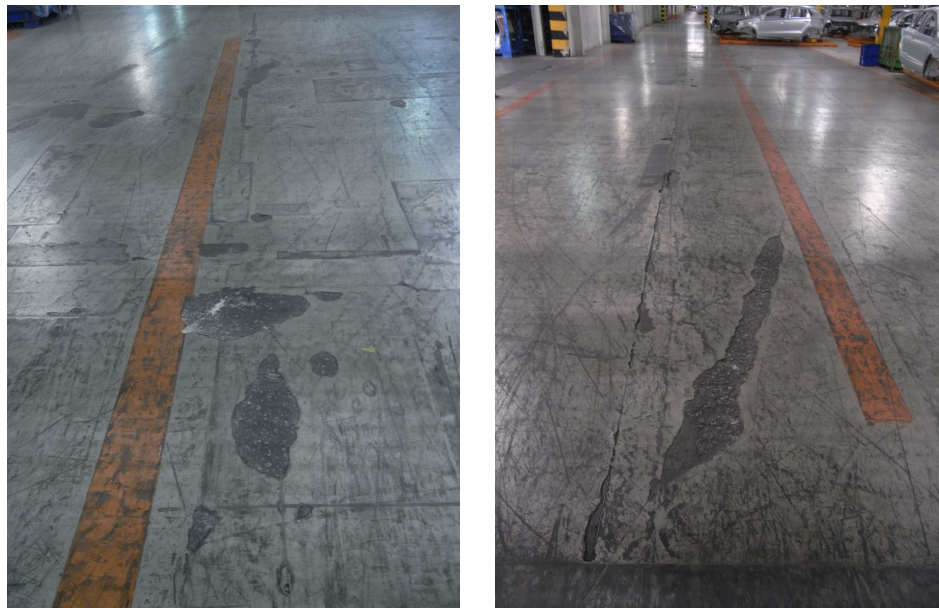
Figura 4.11: Baches en el piso provocan el desplazamiento de las piezas en el contenedor
