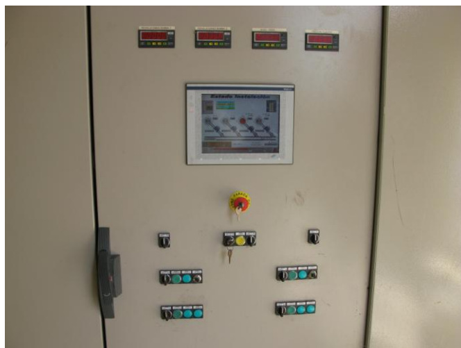
Figura 2.11. Armario de manejo del bombeo y panel view.
