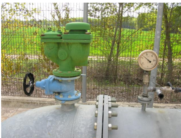
Figura 2.4. Ventosa trifuncional y manómetro en el colector general.
