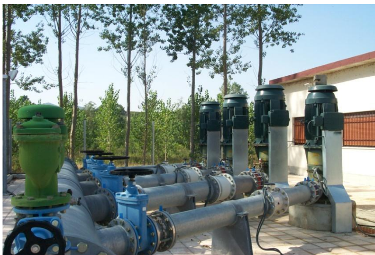
Figura 2.7. Equipos hidráulicos y grupos de bombeo de la estación de bombeo.
