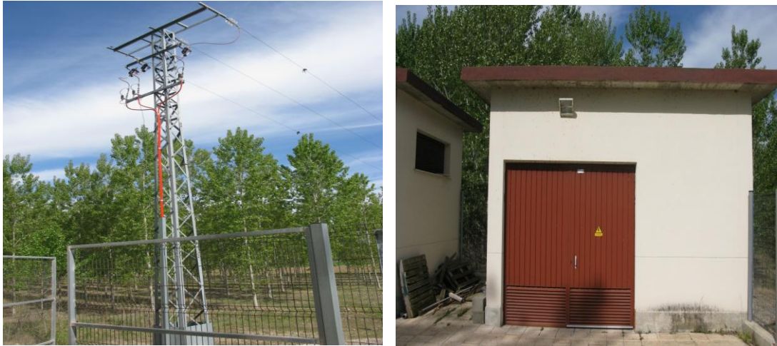
Figura 2.9. Línea eléctrica aérea de AT (derecha). Centro de transformación (izquierda).
