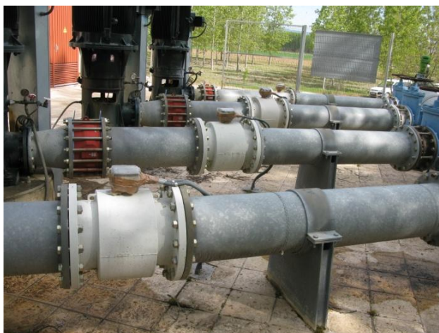
Figura 2.3. Tubería de acero galvanizado con: válvula de retención, carrete de desmontaje, caudalímetro y válvula de compuerta.
