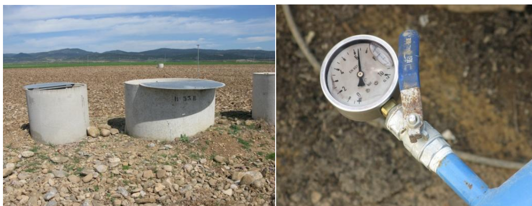
Figura 2.21. Hidrate 53B (derecha). Manómetro aguas arriba del hidrante 53B (izquierda).
