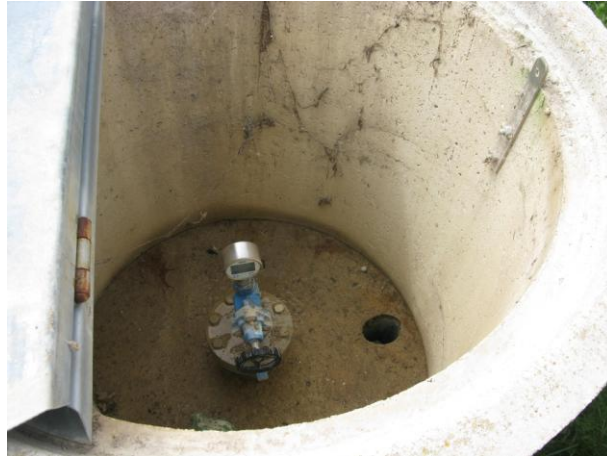
Figura 2.23. Medición de la presión en ventosa próxima al hidrante 21.
