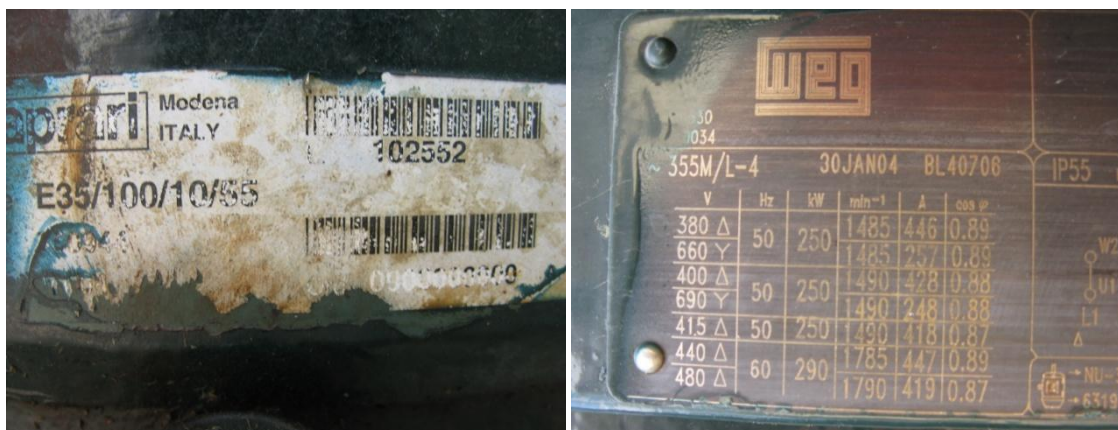
Figura 2.15. Placas de características de bomba y motor n° 2, 3 y 4.
