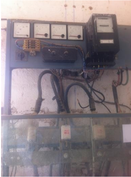
Cuadro de Baja Tensión de CT
