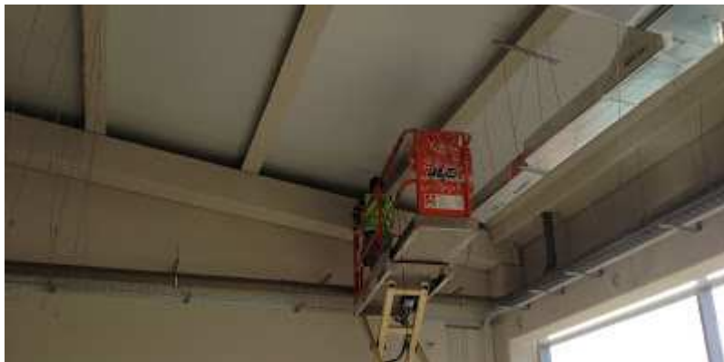
Imagen 35. Sujeciones de conducto de aire acondicionado.
