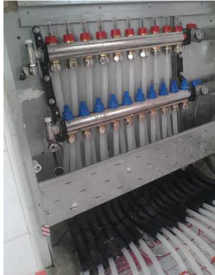
Imagen 26. Colector con tuberías y codos guía.
