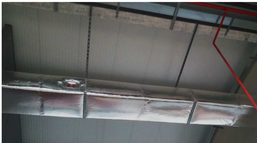
Imagen 34. Sujeciones de conducto de aire acondicionado.
