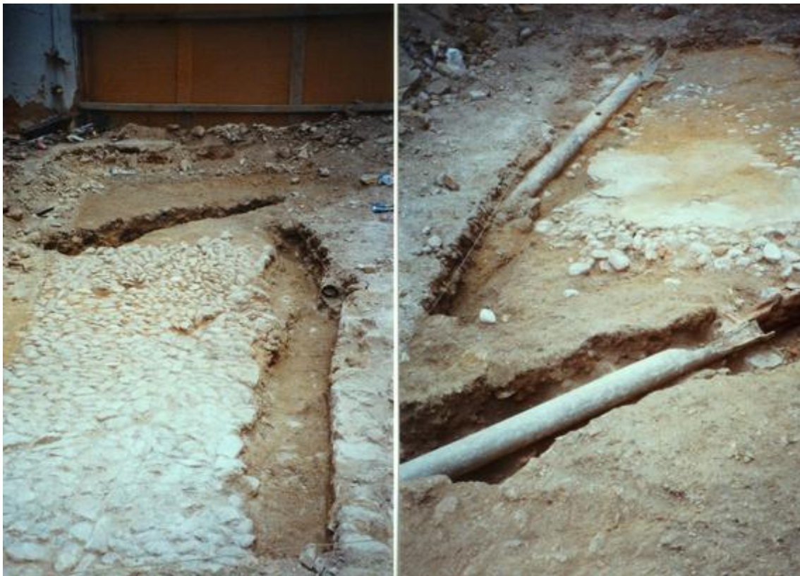
IZQ. Suelo de cantos sobre bodega. DCH. Conducciones de saneamiento de edificio moderno (2003). Fuente: Mikel Ramos.
