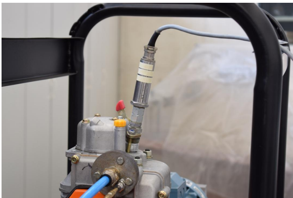
Figura 22. Vista de la colocación final del sensor de presión
