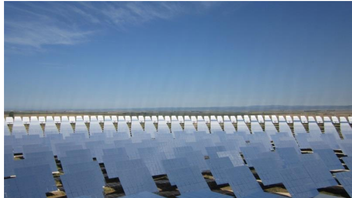
Figura 20: Heliostatos en un campo solar [FCBI energy]
