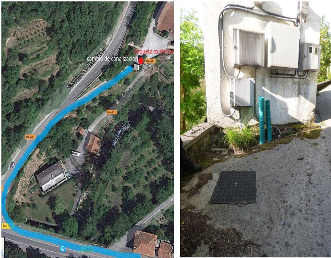
Figura 68: Tramo de fibra en Urriza.
