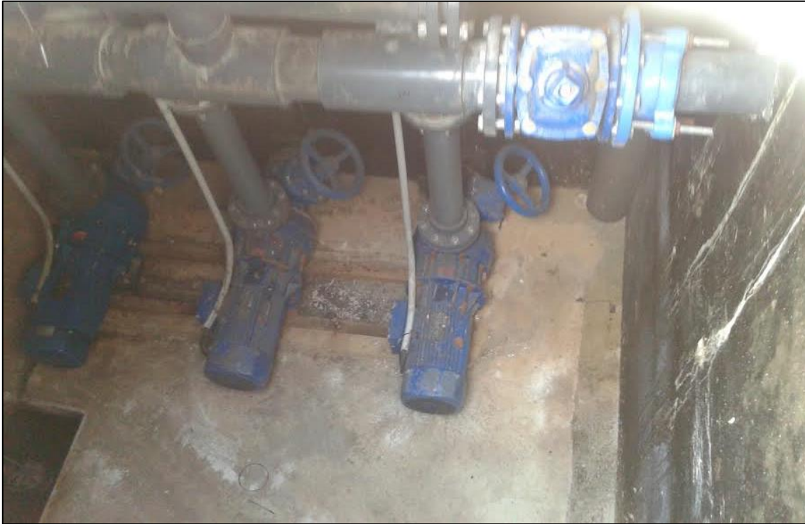
Figura 6. Bombeo de fecales de tres bombas de Vitoria-Gasteiz.
