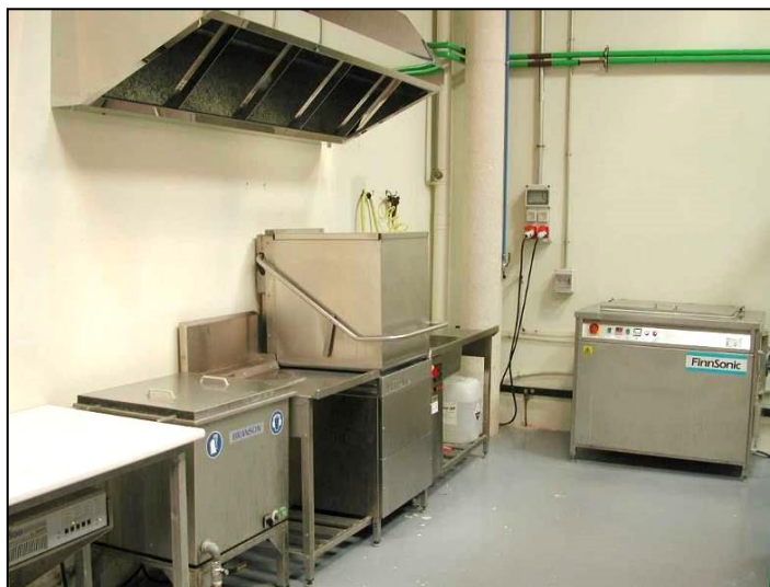
Figura 3.3: Vista parcial de la línea de limpieza de AIN.
