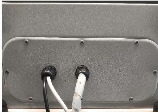
Figura 3 Paso de cables por zona inferior del armario
