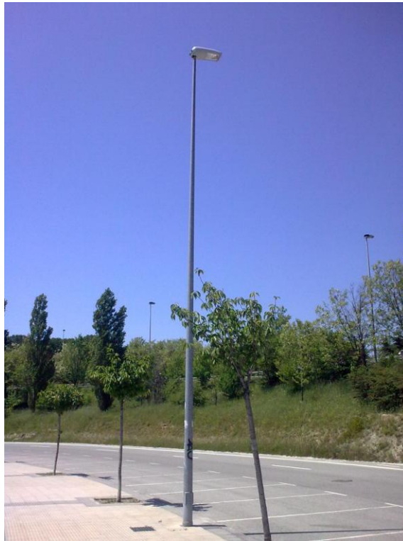
Imagen 4. Detalle de luminaria perimetral.
