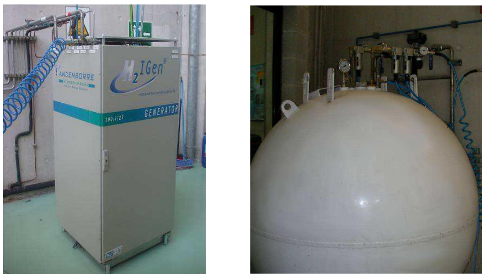
Fig.13 Electrolizador y depósito
