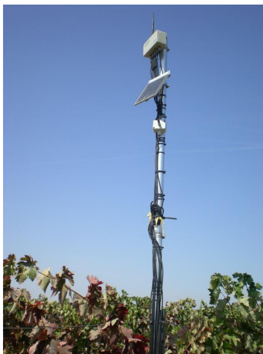
Figura 10. Estación transmisora de datos.
