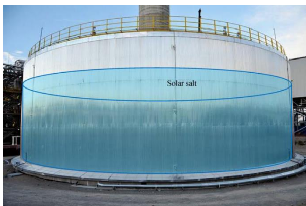
Figura 4. Tanque de almacenamiento de sales fundidas para la planta de potencia solar Crescent Dunes.
