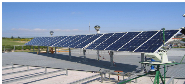
Figura 2: Fotografía del campo fotovoltaico.
