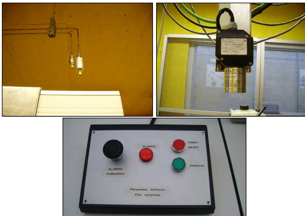
Figura 3.21.- Sensores de hidrógeno de la celda y control de alarmas
