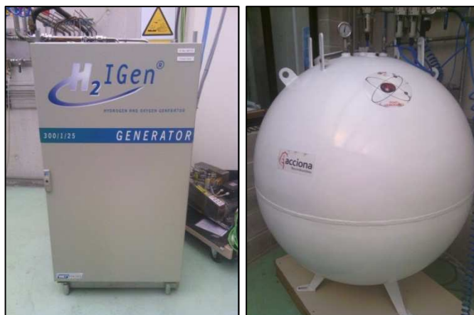
Figura 2.2.- Electrolizador del Grupo Hidrógeno y depósito de almacenamiento de hidrógeno
