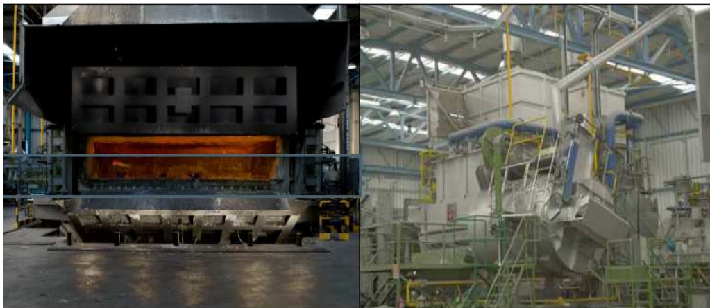
Figura 2.8: La torre fusora (derecha) y el horno de reverbero (izquierda)
