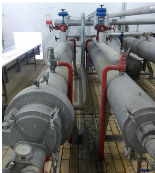
Figura 15: (De izq. a dcha.) Intercambiadores de calor 1 y 2
