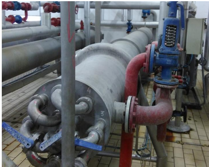
Figura 16: Intercambiador de calor de carcasa tubos número 3
