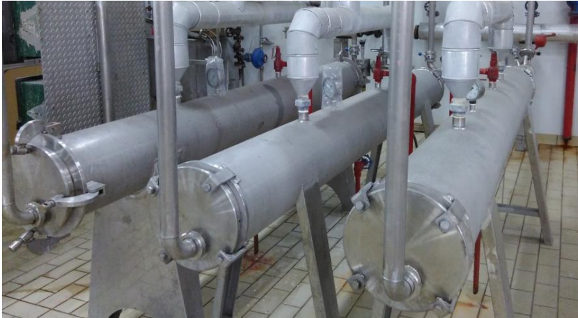
Figura 19: (De dcha. a izq.) Intercambiadores de calor 9, 10 y 11 de la zona de llenado en caliente
