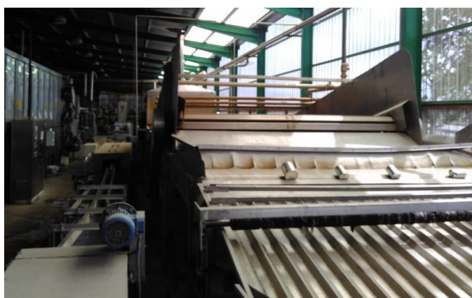
Figura 13: Zona de enfriamiento del Esterilizador STR-RA 30-15
