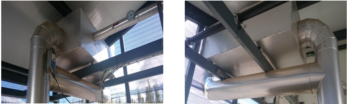
Fig 10. Intercambiador de calor
