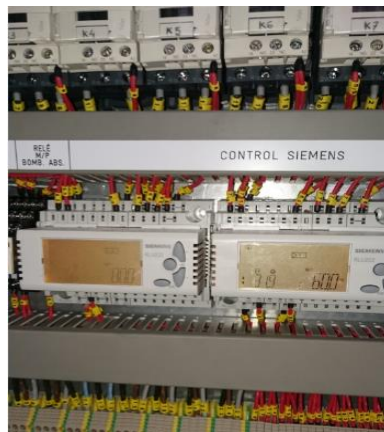
Fig 13. Sistema de control siemens
