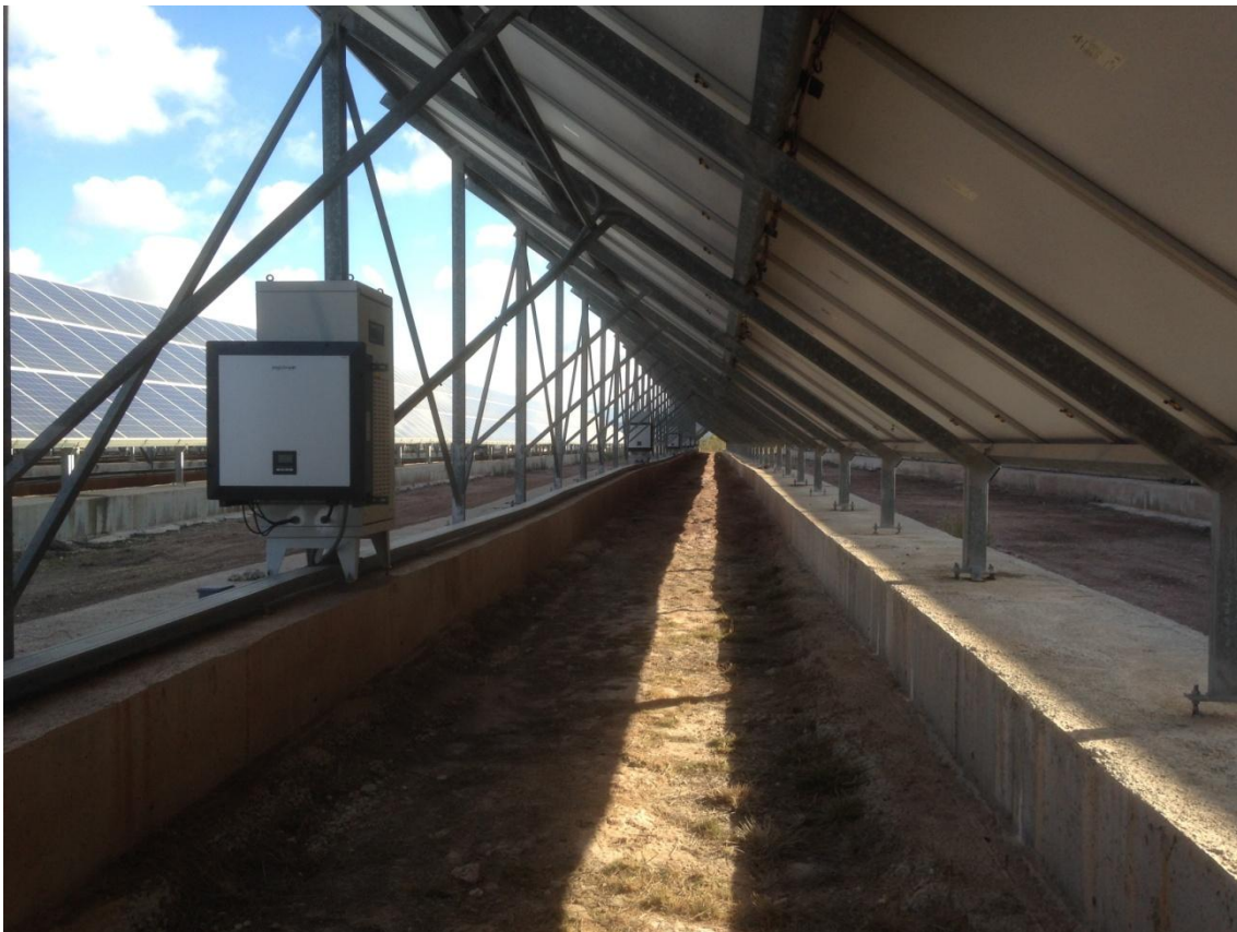
Imagen 4-1: Fotografía de la instalación de la planta de Villena.
