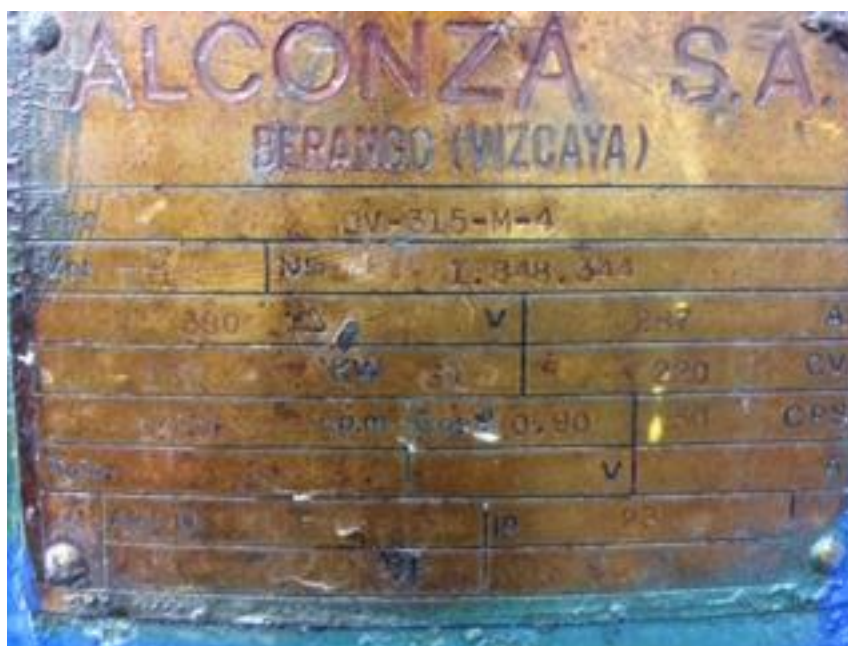
Figura A.2.2: Placa de los motores de las bombas 1, 2 y 3
