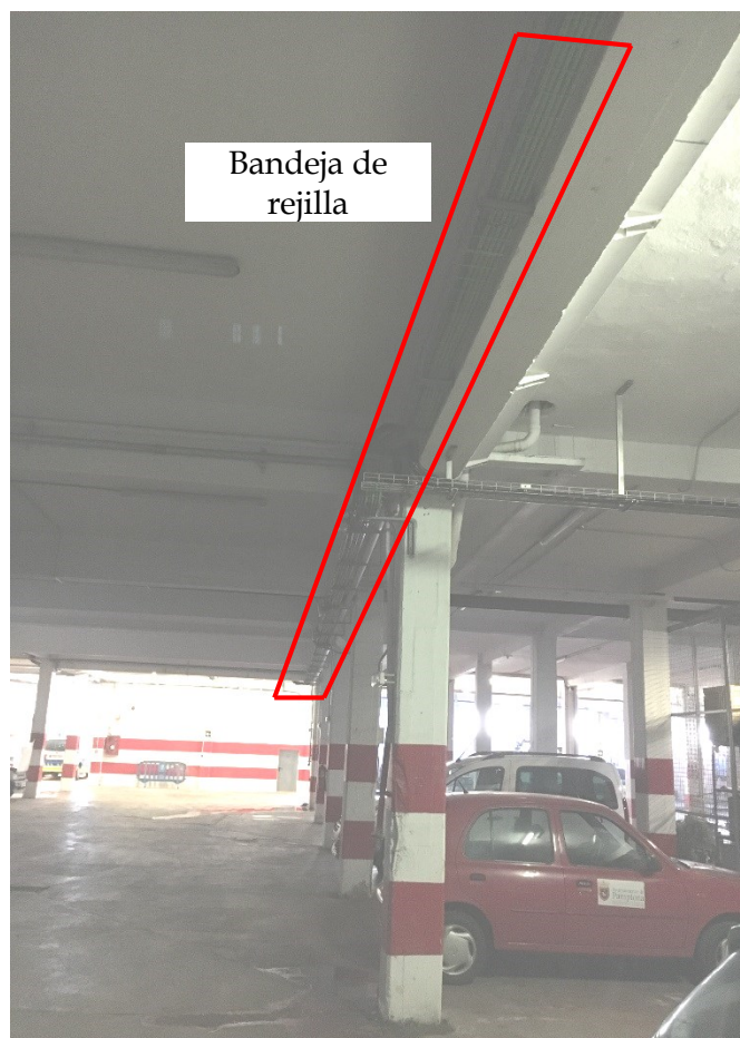
Ilustración 7. Bandejas en rejilla de la planta -1
