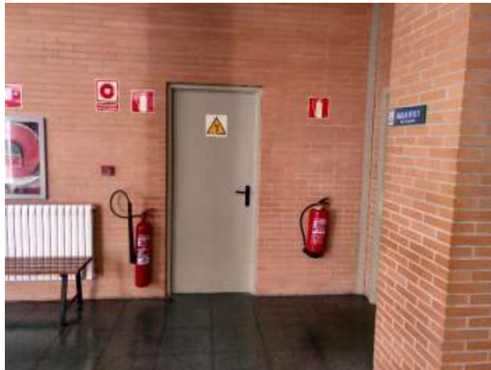
Ilustración 37 Cuarto de contadores
