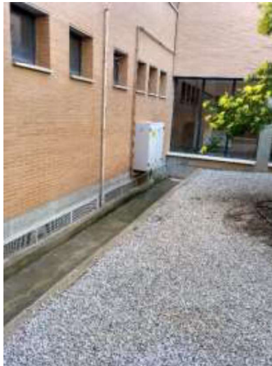
Ilustración 36 Armario de gas
