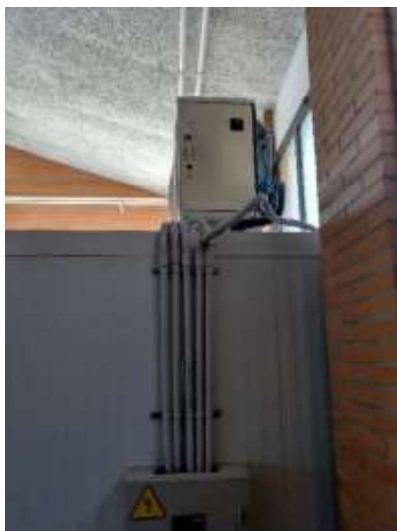
Ilustración 30 Climatización de cámara húmeda
