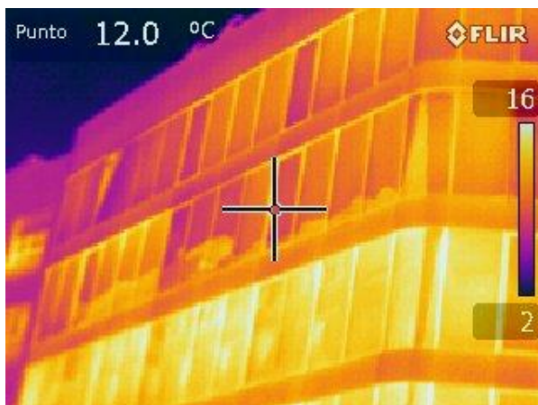
Ilustración 33: Termografía fachada suroeste
