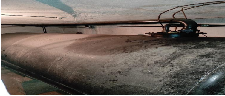
Ilustración 20: Depósito de gasoil
