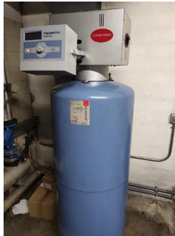
Ilustración 19: Vaso de expansión del sistema de calefacción
