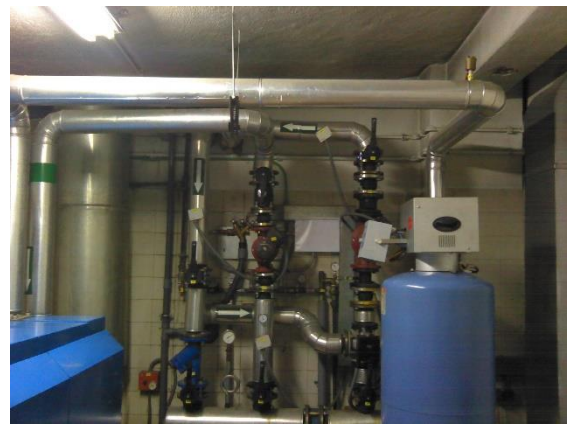
Ilustración 37: Bombas de calefacción
