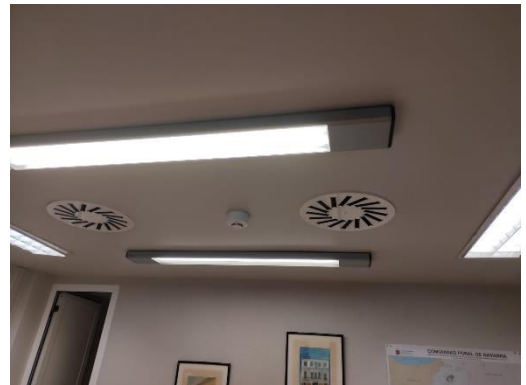
Ilustración 7: Luminaria de 2 tubos de 36 W. Despacho 3.5
