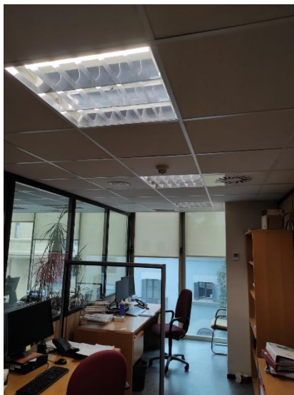
Ilustración 5: Luminaria de 3 tubos de 18W. Oficina 2.2.
