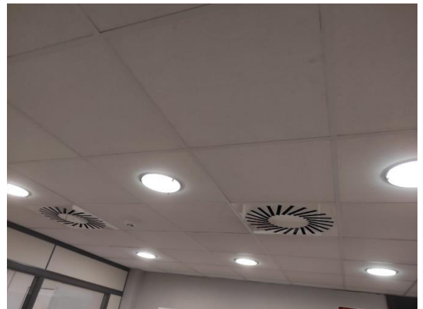
Ilustración 10: Luminaria lámpara fluorescente compacta 26 W. Despacho 3.6.
