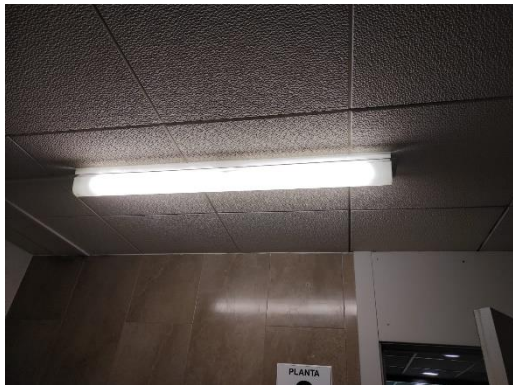
Ilustración 8: Luminaria de 1 tubo de 36 W. Escaleras
