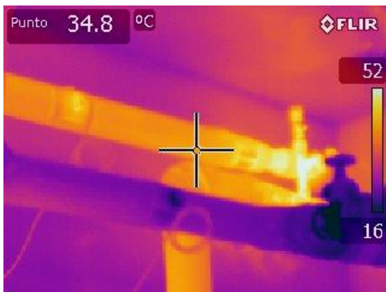
Ilustración 42: Termografías de los sistemas de distribución de climatización
