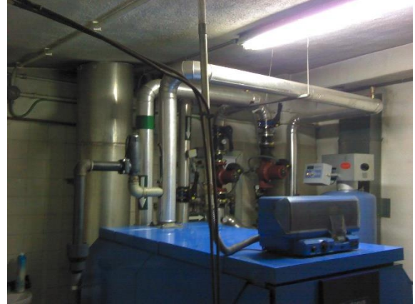
Ilustración 40: Sala de calderas
