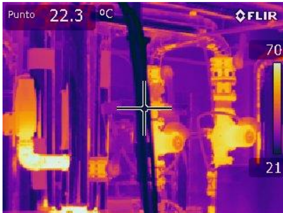
Ilustración 41: Termografía sala de calderas
