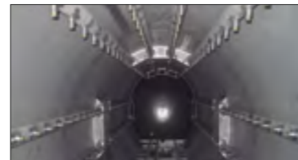
Sistema de duchas de agua Water spray system
