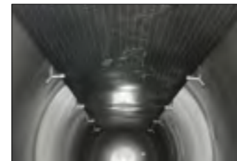
Sistema cascada de agua Water shower system
