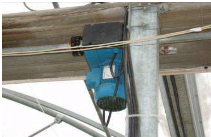
Figura 5.9. Motor para el accionamiento de la pantalla de sombreo o térmica
