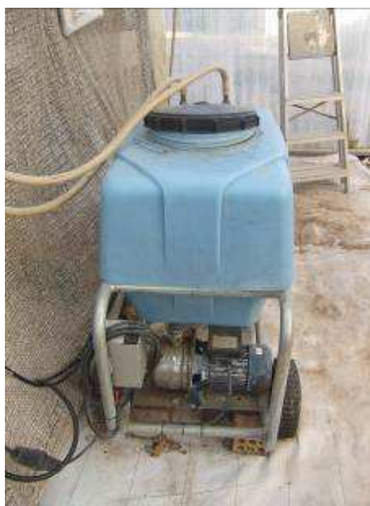
Figura 5.12. Equipo de bombeo para los nebulizadores
