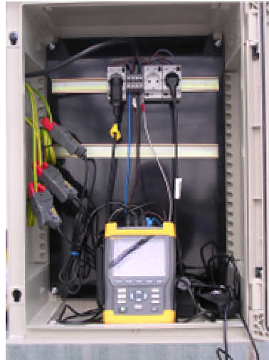
Figura 6.1. Colocación del Fluke 435
