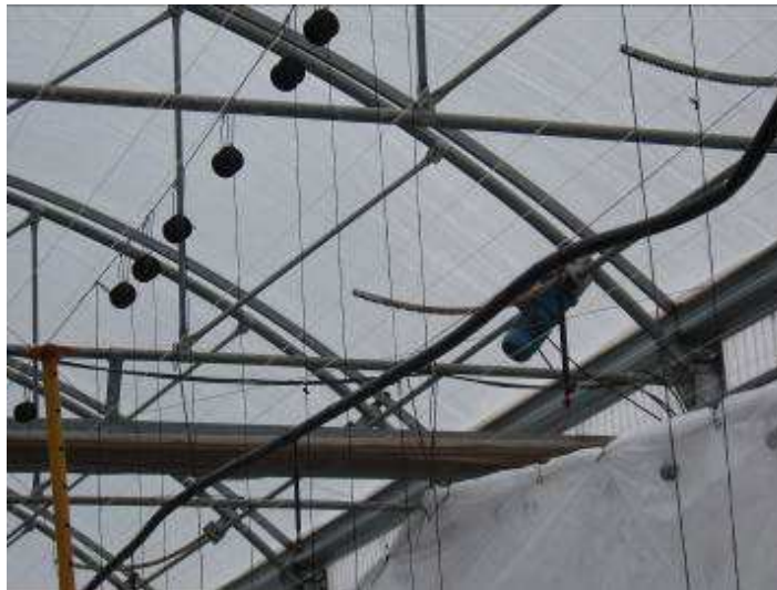
Figura 5.6. Ubicación de uno de los motores para apertura y cierre de ventanas
