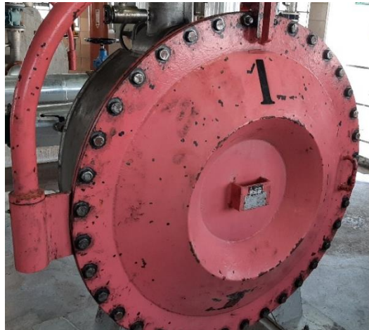
Figura 5.25: Intercambiador de calor
