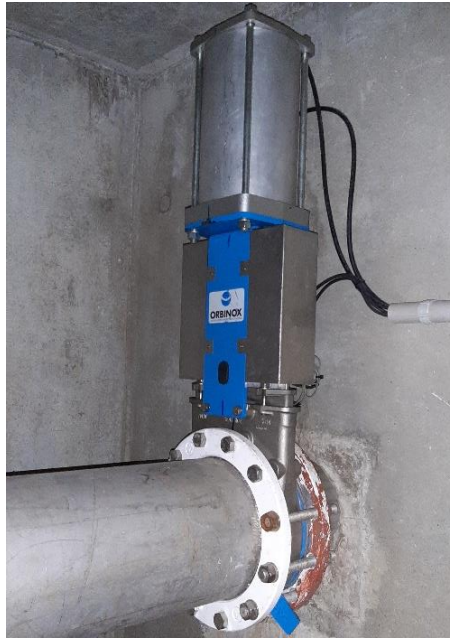
Figura 5.28: E.V. alimentación fango a digester primario
