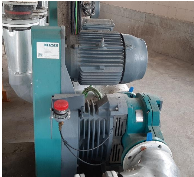
Figura 5.23: Bomba fangos a intercambiador
