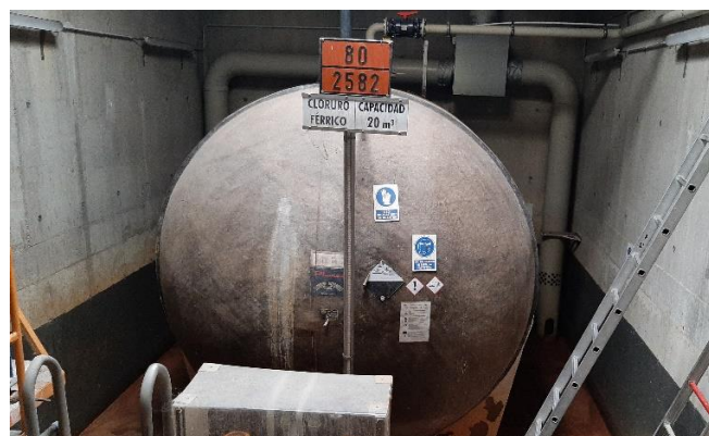
Figura 5.5: Depósito de cloruro férrico
