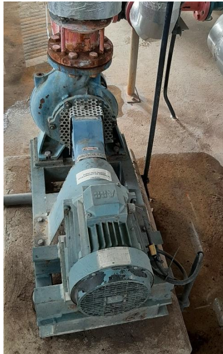
Figura 5.24: Bomba agua caliente a intercambiador
