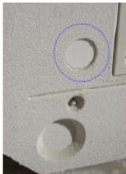
Figura 1.3: Detalle de entrada auxiliar de acometida de BT
