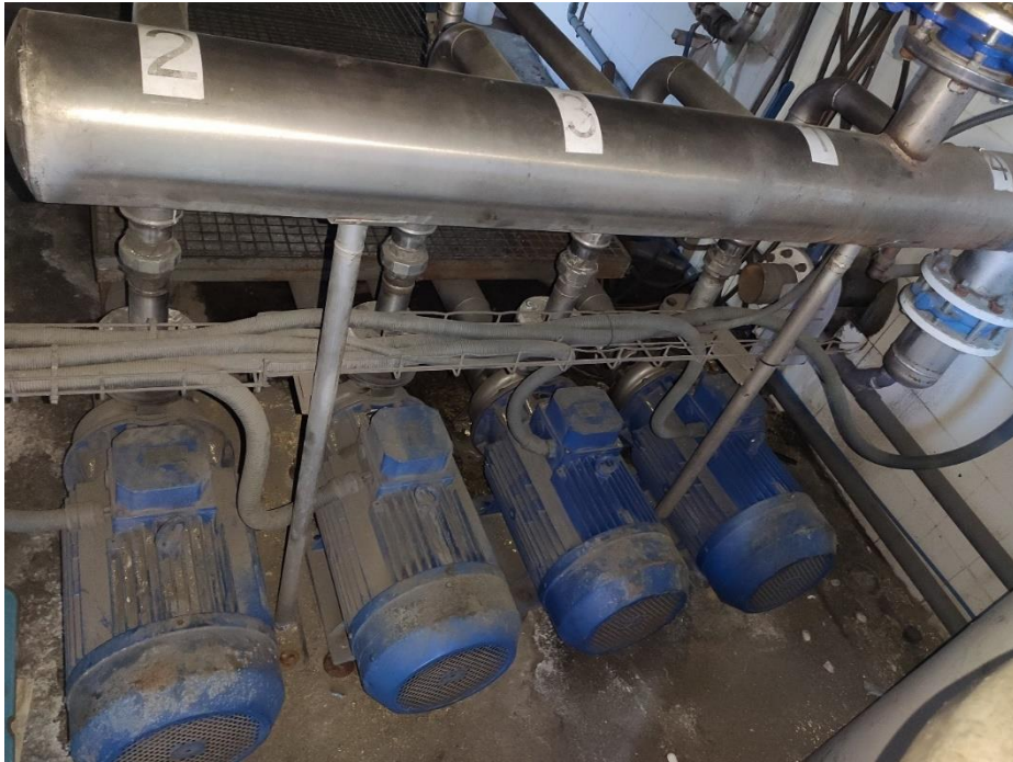
Figura 10: Bombas de la torre de refrigeración
