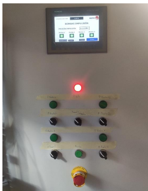
Figura 81: Botonera del nuevo cuadro eléctrico
