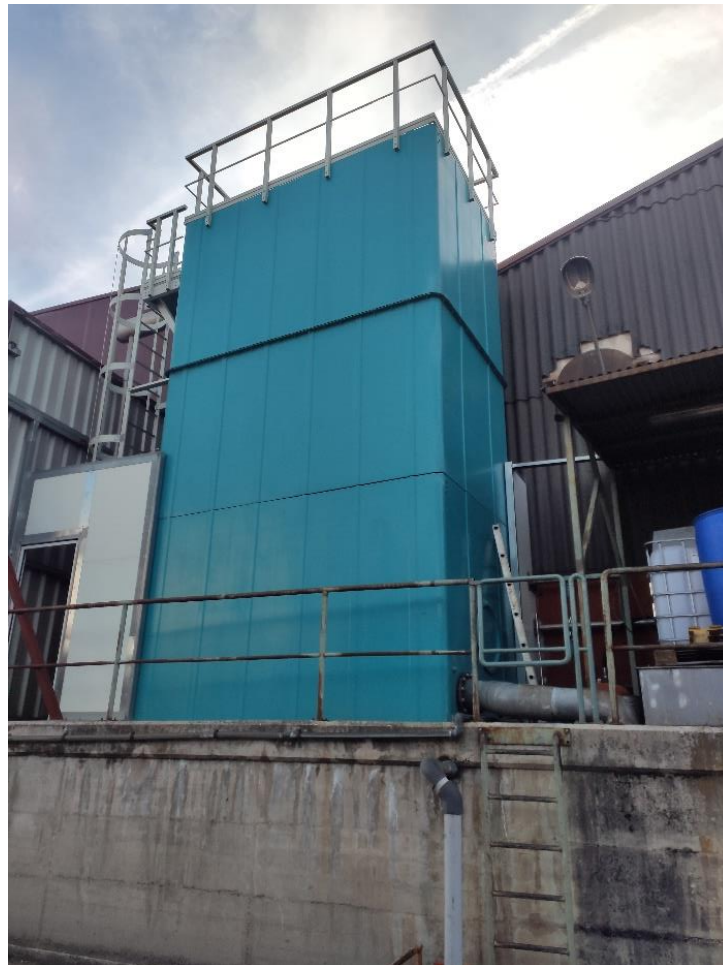
Figura 9: Torre de refrigeración
