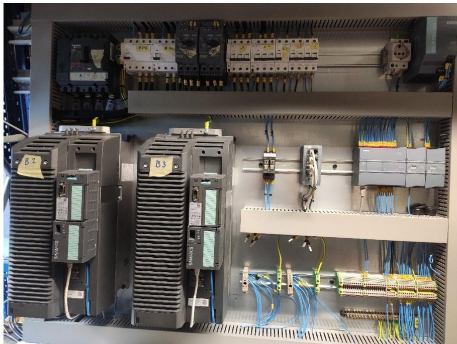
Figura 16: Cuadro secundario a falta de los 2 arrancadores suaves
