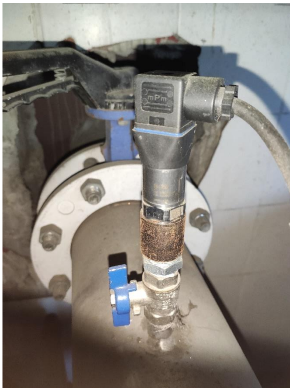
Figura 11: Sensor de presión la Torre de refrigeración
