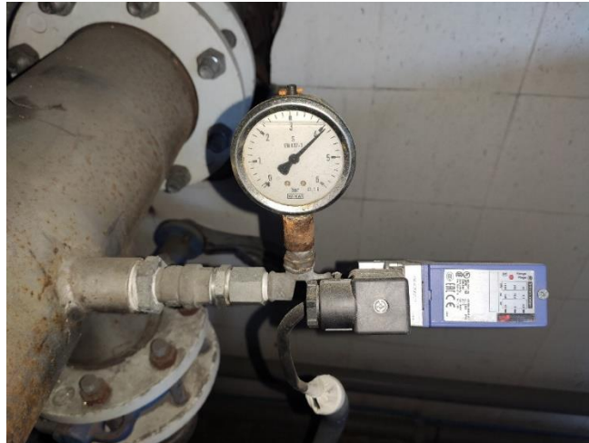
Figura 12: Manómetro de presión de la Torre de refrigeración y el presostato
