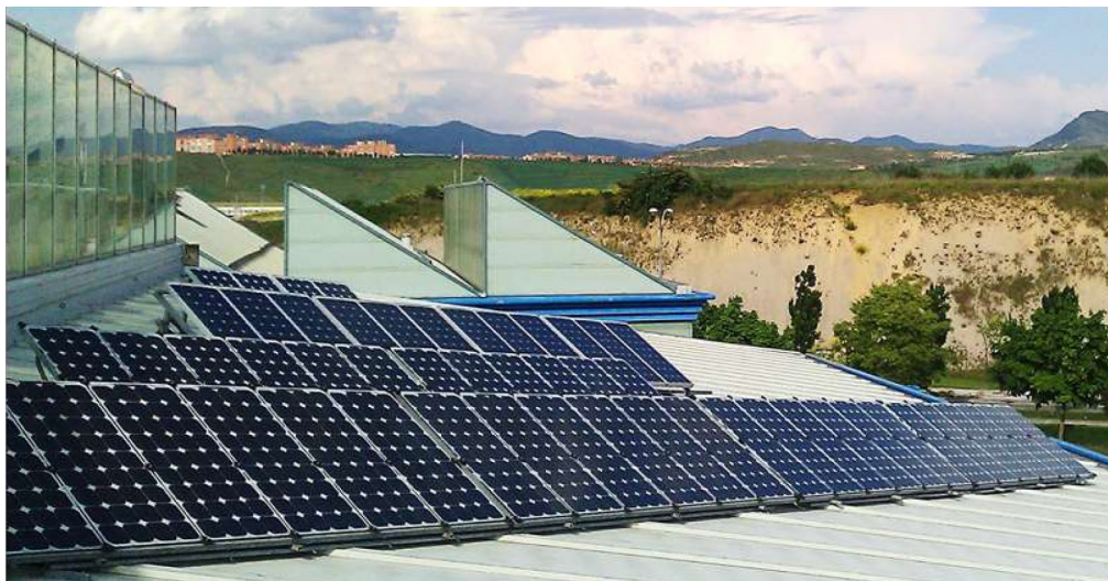
Figura 6.4 Instalación paneles fotovoltaicos microrred en el tejado del edificio Los Pinos
