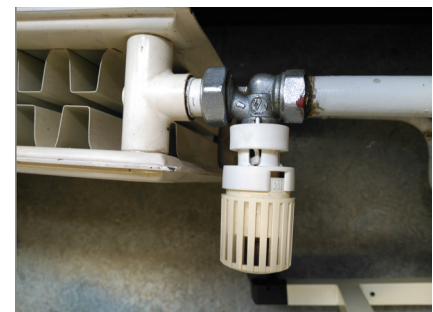
Figura 21.4: Regulador de temperatura colocado en un radiador de la Universidad Pública de Navarra. Foto de Patricia Aranguren.
