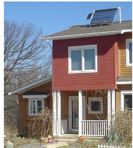
Figura 30.2: Un panel solar térmico para calentar agua para una familia en Michigan (EE.UU.). La bomba del sistema está alimentada por un panel fotovoltaico pequeño que se puede ver a la izquierda del panel solar térmico.
