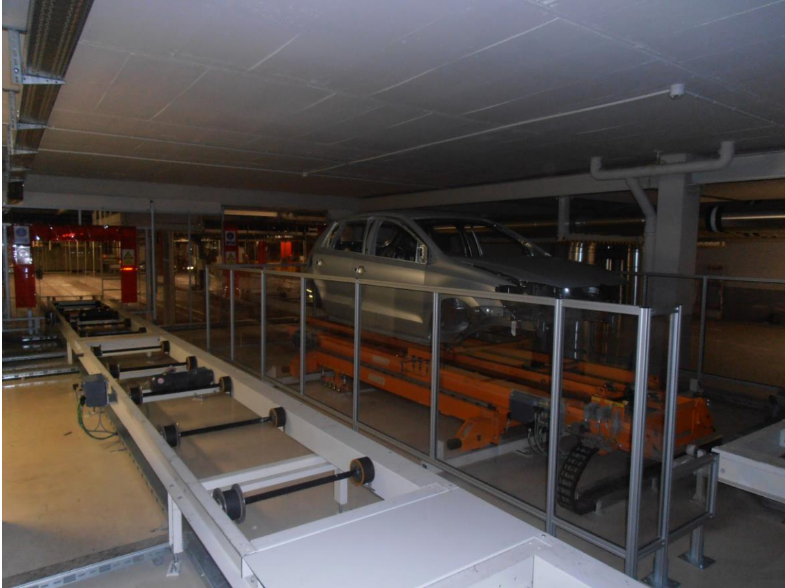
SEGMENTO DEL SKID 1 (TRAMO DE TRANSPORTE)
