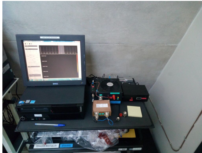
Figura 10. Puesto de trabajo de la antena de radio.
