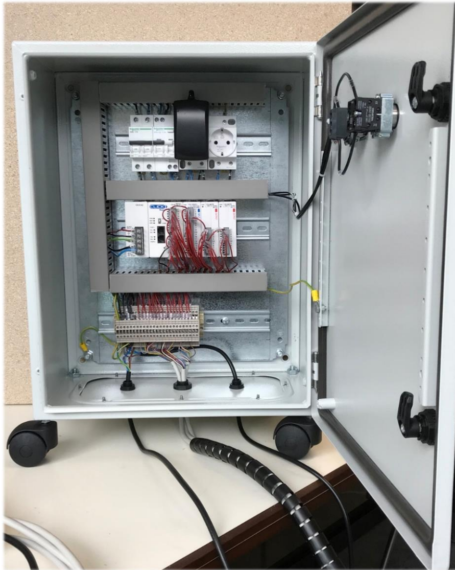
Ilustración 50 – Cuadro eléctrico completo
