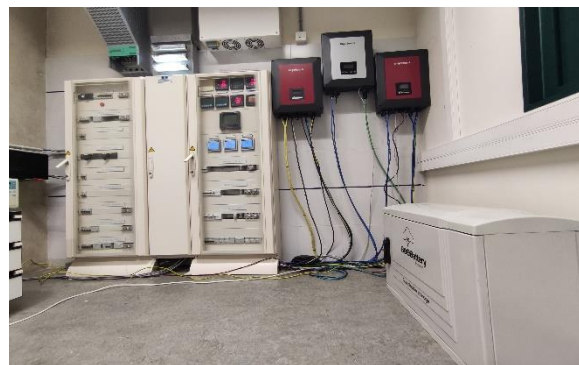
Figura 14- Principales componentes de la microrred: Batería de BeePlanet, inversores y sistema de control
