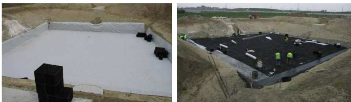
Figuras 37 y 38. Sistema de filtración de Atlantis.
