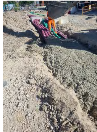
RED TELEFONÍA, TELECO E IBERDROLA
