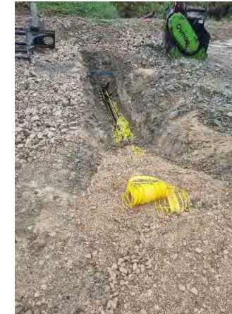
INSTALACIÓN GAS EJE 2
