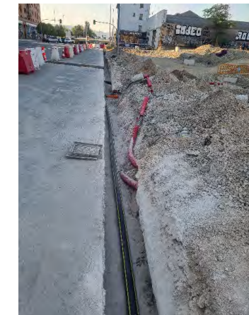
INSTALACIÓN GAS EJE 1
