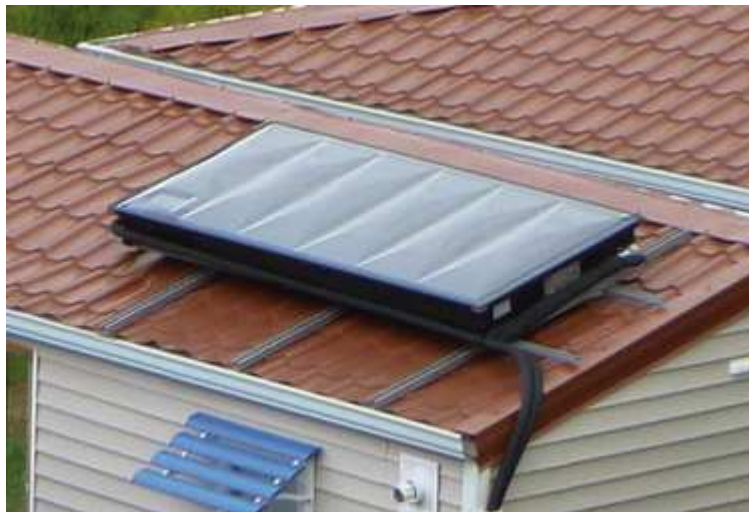
Imagen 49. Instalación colector solar TODO EN UNO
