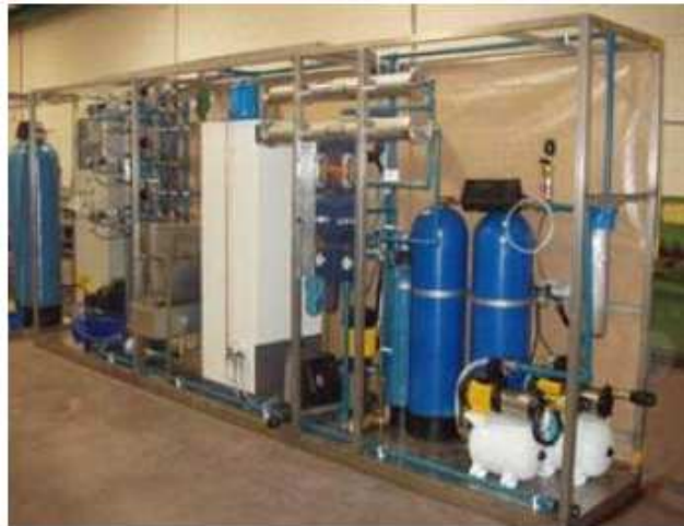
Imagen 56. Equipos descalcificador y declorador
