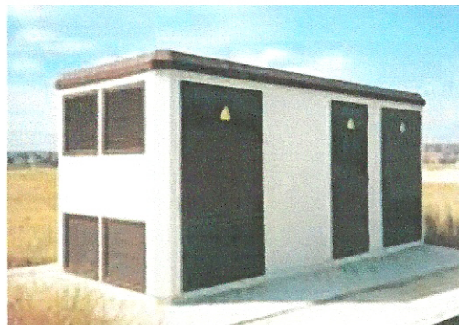
PFU-5 con 2 transformadores de 1000 kVA
