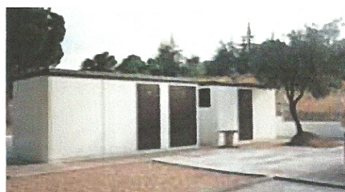
PFU-5 con 1 transformador y PFU-4
