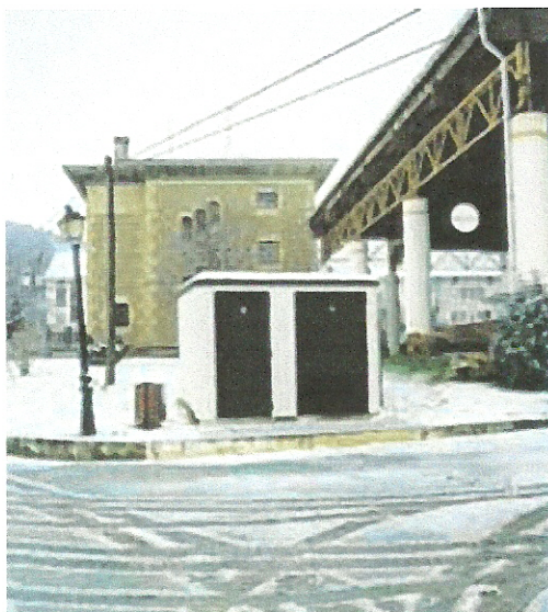
PFU-3 con 1 transformador
