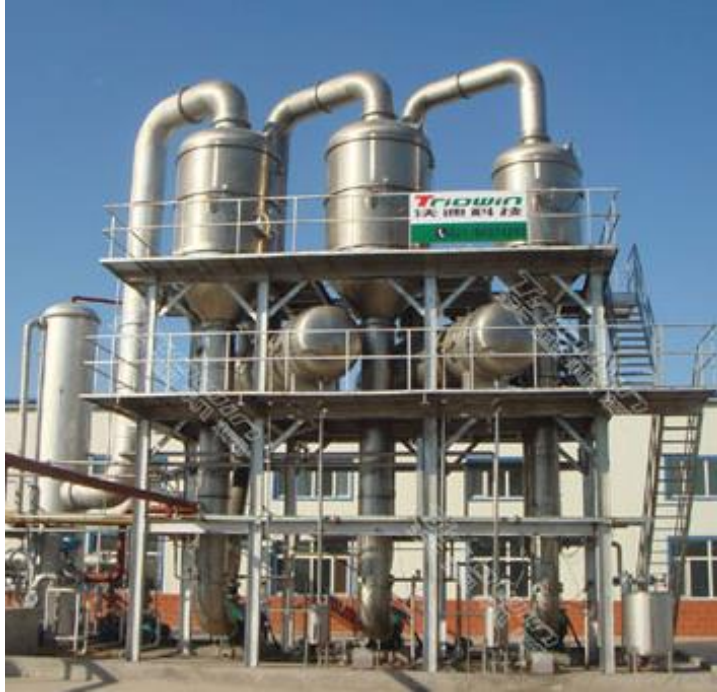
Evaporador de triple efecto a vacío de tubos verticales y circulación forzada
