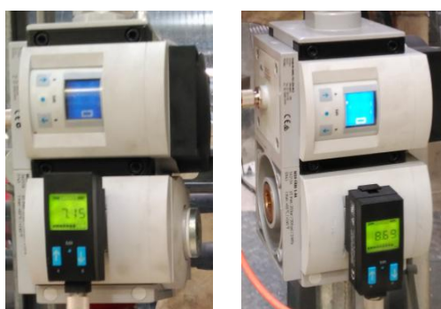
Ilustración 4.13 - Contadores y manómetros de 6 y 12 bares
