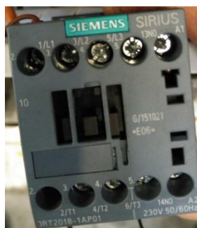
Ilustración 5.6 - Relé de Siemens, empleado para contabilizar el consumo
