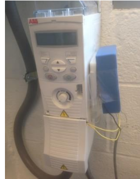
Figura n°79. Variador de frecuencia para variar la velocidad del motor.
