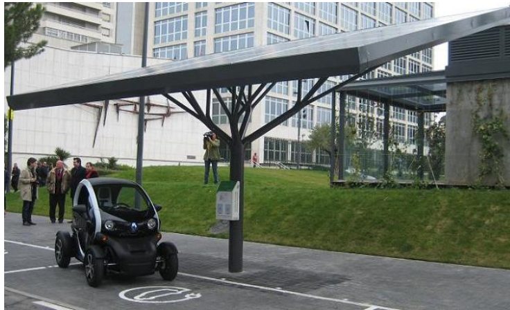
Figura 7. Electrolinera de la empresa Emerix
