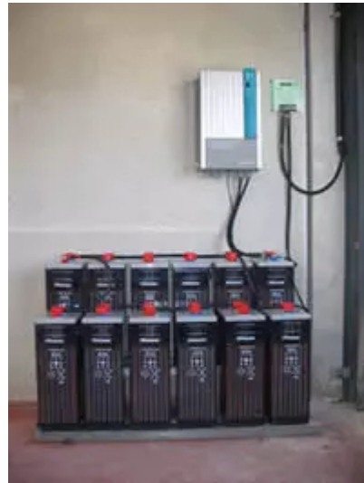
Figura 12. Sistema de almacenamiento con baterías.
