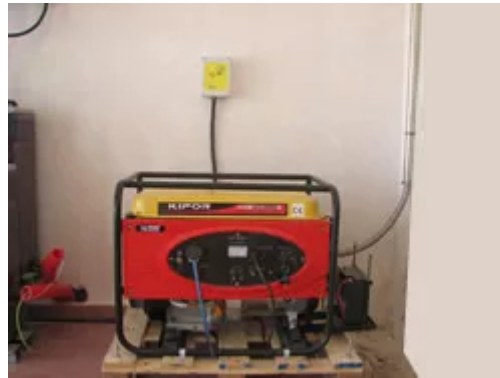
Figura 13. Generador de refuerzo.
