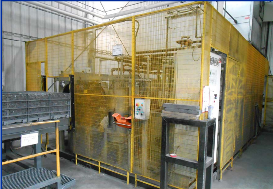
Figura 21. Cuba de limpieza. Vista general.
