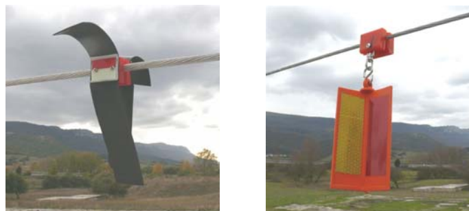
Figura 16. Balizas salvapájaros de alas de neopreno (izquierda) y de aspas giratorias (derecha).
